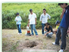
委員們視察營區地陷情況
